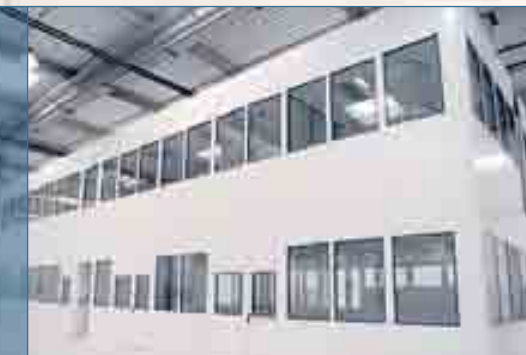
Oficinas a dos niveles para áreas administrativas
